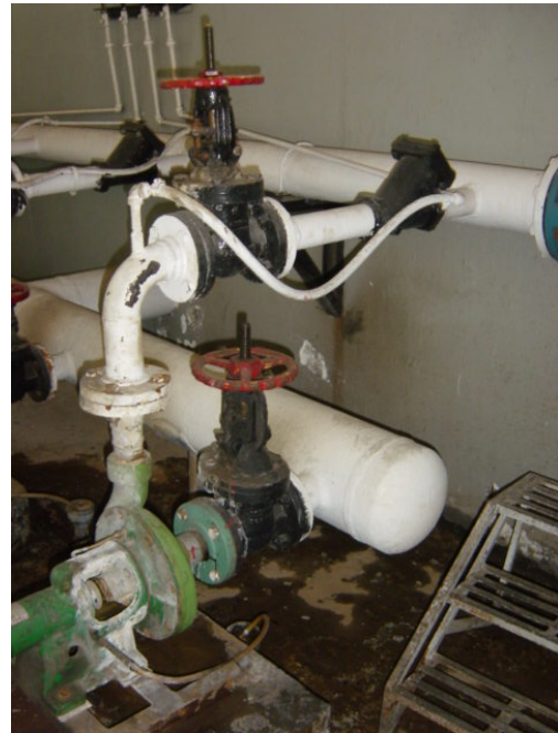
VALVULAS Y CHECKS ACTUAL
