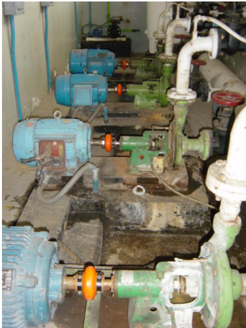
BOMBA INEFICIENTE ACTUAL
