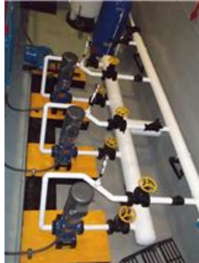
BOMBAS (3) LAVANDERIA D.F.
