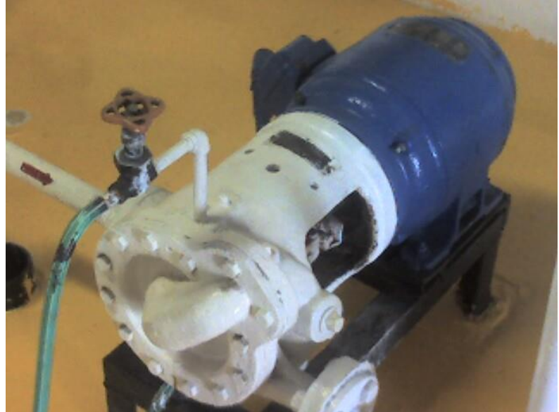
BOMBA INEFICIENTE ACTUAL
