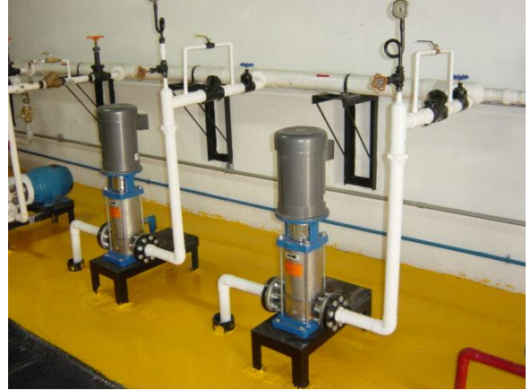
BOMBAS (3) LAVANDERIA D.F.
